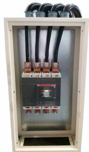
Панель защитного выключателя
